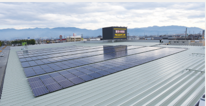
MEGAドン・キホーテ甲府店の太陽光パネル
